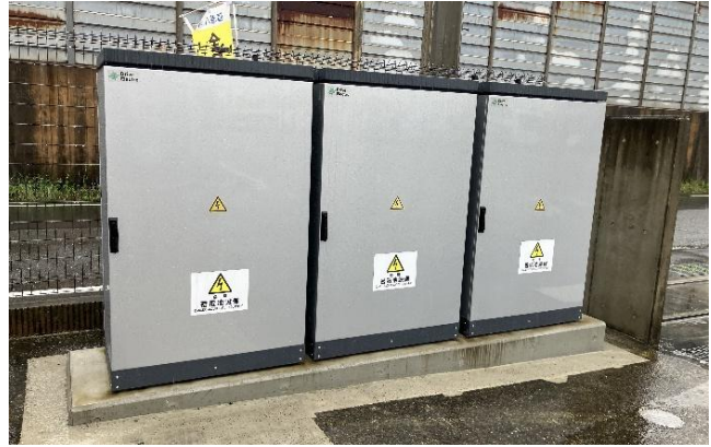
図 3：充電器に併設した蓄電池
