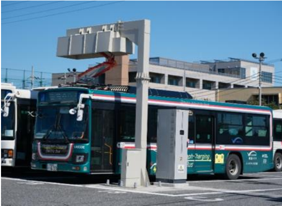
図 2：営業所設置のパンタグラフ式充電器で充電中の EV バス
